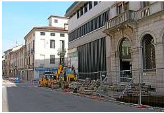
Da oggi si comincia a lavorare nel tratto di via Trento. ZORZAN
